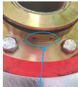
漏水孔垂直朝下
